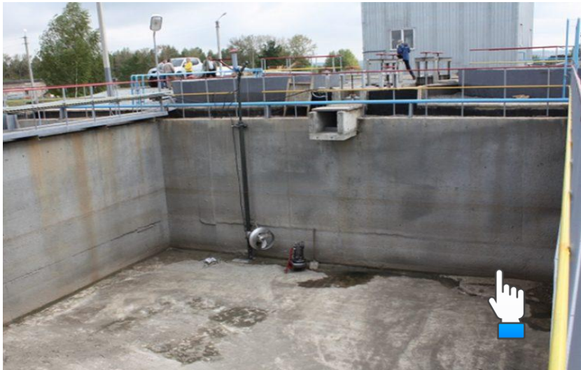
Резервуар усреднитель-смеситель с механическим перемешиванием
